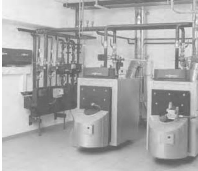
د دوو بایلرو څخه جوړه شوي بوډه د ستگناه ، په هغوي پوري تړلي بوټا برتروته. پمپ سټیشن اود بایلرو د تنظیم او کنټرول وسایل (منبع: د فیسمن Viessmann د شرکت معلوماتي پاڼي )
