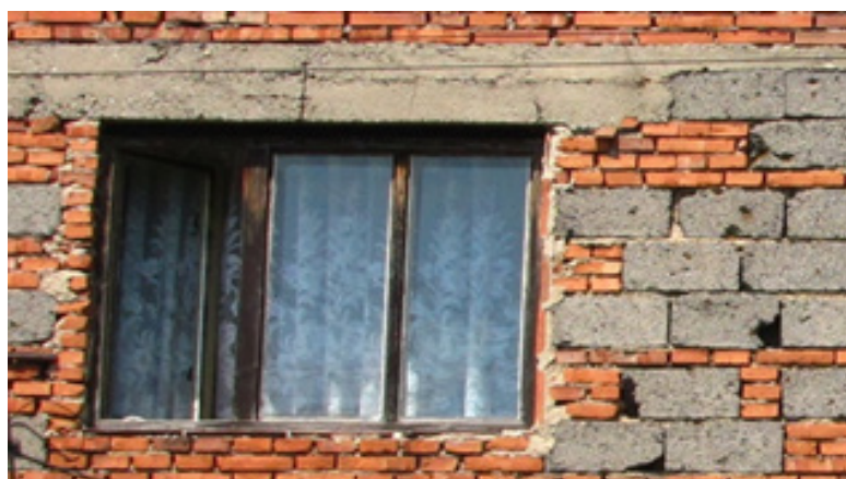
تصویر 17 - الف یک مثال موثق پل حرارتی ناشی از ترکیب مواد
