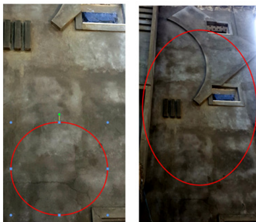
تصویر 12 - الف اثرات بوجود آمدن نقطه شبیم و عدم تبخیر آن در نمای بیرونی یک تعمیر در شهر هرات
